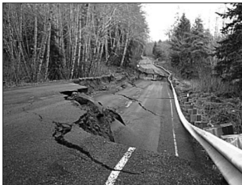
2) Рис. 1. Приклад втрати стійкості укосу земляного полотна 1) залізничного, 2) автомобільного
