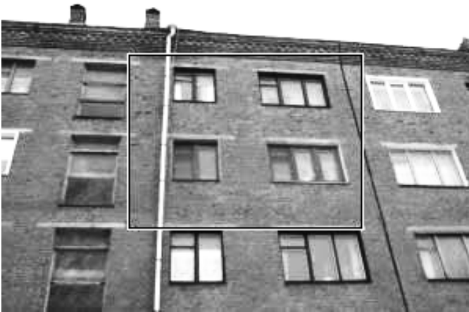
Рис.1. Втрати тепла із швів багатоповерхового житлового будинку
