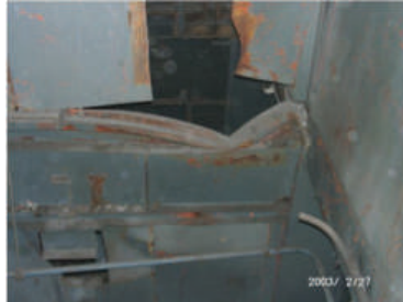
Рис.15. Повреждение балки на отметке -3,000м.
