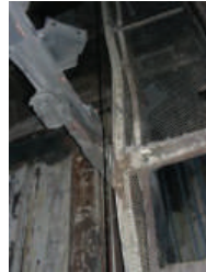
Рис.14. Деформация вертикальных элементов (подвесок) лифтовой шахты
