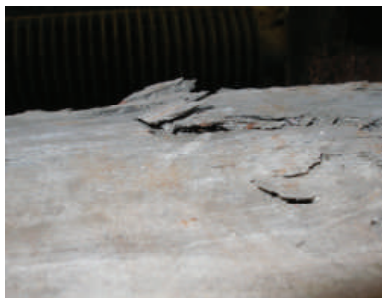
Рис. 3 Разрушение сжатой зоны бетона
