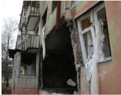
Рис. 2. Отклонения от проектного положения и обрушение трехслойных стеновых панелей и плит перекрытий в панельном здании серии 1-464 А.
