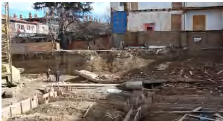
Рис. 1. Разрушение торцевой стены жилищного трехэтажного дома от неверного подкрепления сваями котлована строящегося многоэтажного дома.
