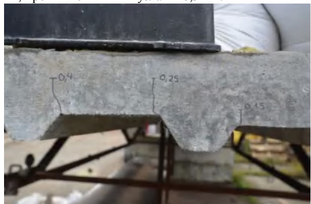
Рис. 13. Тріщини в плиті (КСБ-3)
