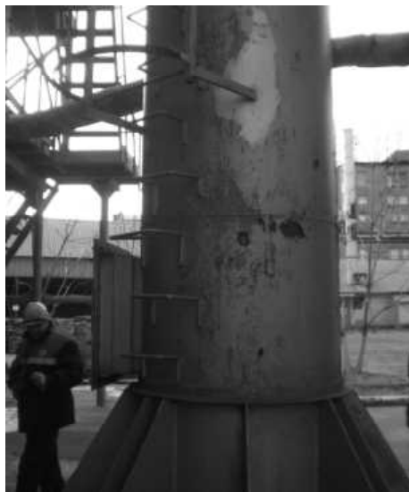
Рис 5. Коррозия ствола и разрушение защитного лакокрасочного покрытия дымовой трубы /Corrosion of the barrel and destruction of the protective paint coating of the chimney gas purification
