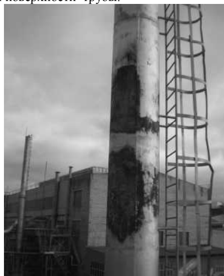
Рис 6. Коррозия ствола дымовой трубы печи обжига огнеупоров /
