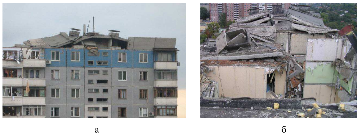
Рис. 6. Пошкоджена четверта секція будівлі: а – загальний вигляд; б – вигляд зверху.
