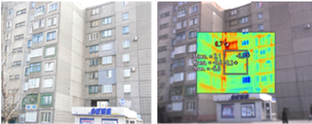
Рисунок 7 – Блокировка девятиэтажных жилых домов серии 121 и вид торца здания через тепловизор
