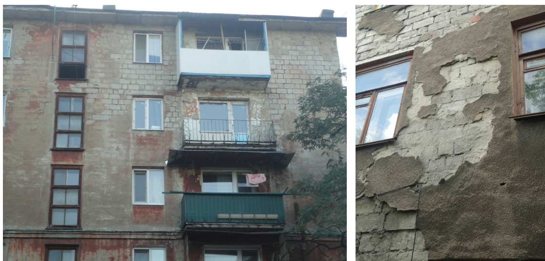
Рисунок 1 – Жилые дома с поврежденной наружной штукатуркой
