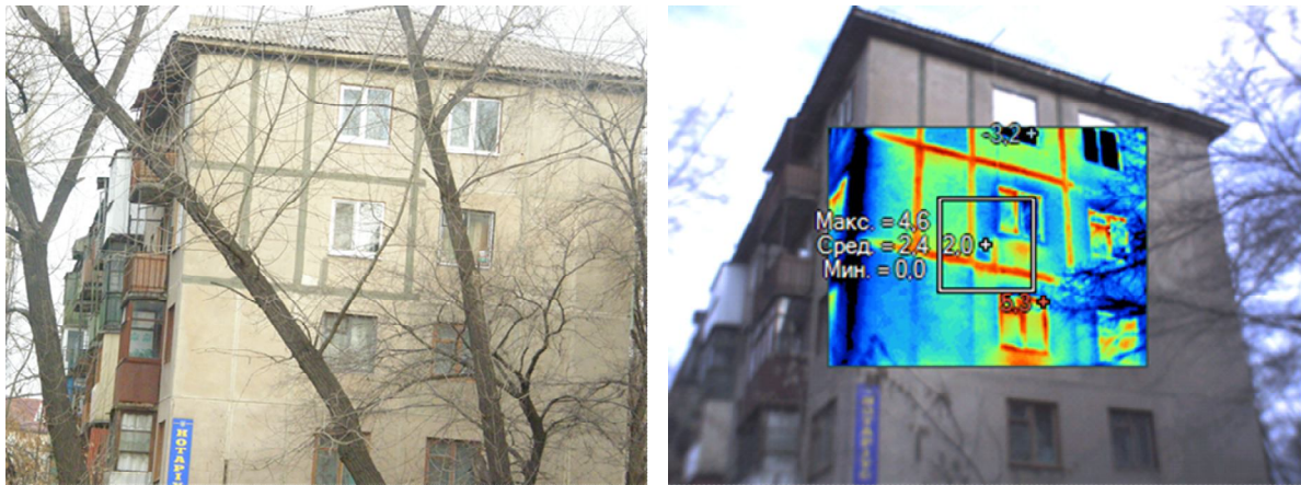
Рисунок 3 – Теплопотери в жилом доме из блоков с поврежденной наружной штукатуркой
