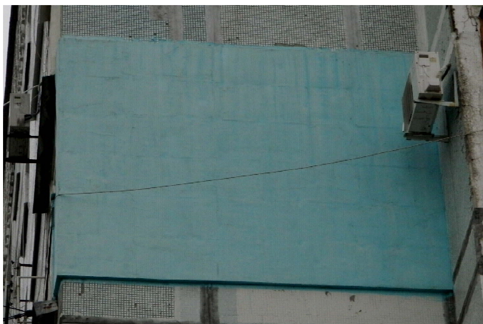
Рисунок 1. Вид деформированных плит утеплителя.
