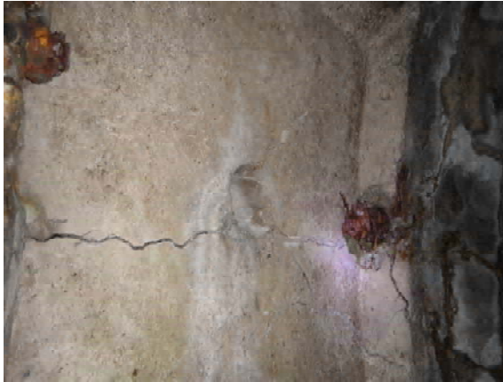
Рисунок 4. Тріщина у бетоні верхнього тюрінгу оправи ДГ.
