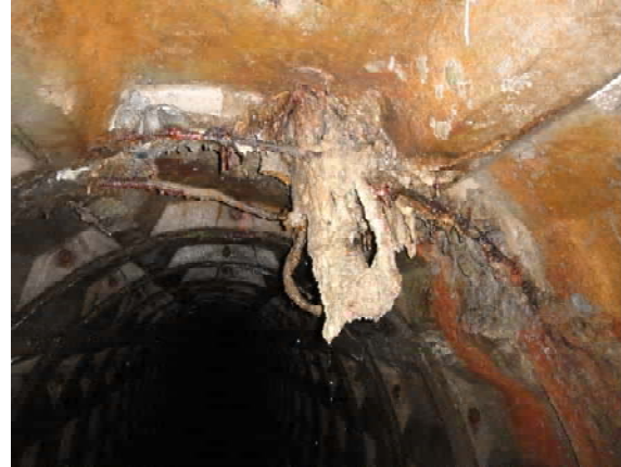
Рисунок 5. Пошкодження захисного шару бетону і корозія арматури тюрінгів оправи у центральній частині ДГ.
