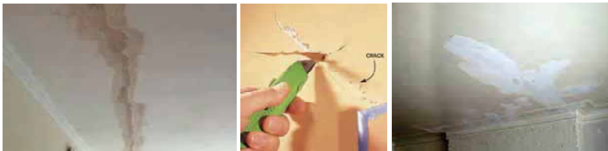
Рисунок 1. Характерные дефекты в гипсокартонных конструкциях.
