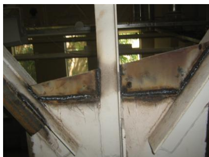
Рис. 7. Увеличение длины сварных швов
