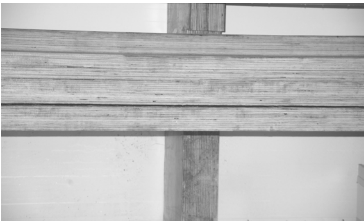
Рисунок 3: Трещина по плоскости сплачивания
