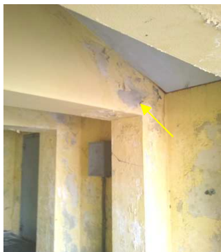
Фото 3. Замокание внутренних стен парковки под эксплуатируемой кровлей. Отслоение штукатурного слоя стен
