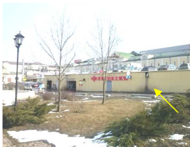
Фото 1. Выезд на крытую парковку. Замокание наружных стен из-за неисправности организованного водостока
