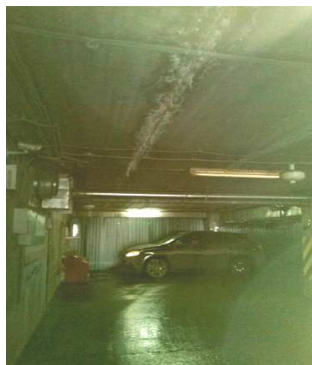
Фото 4. Замокание и промерзание плит перекрытия над крытой парковкой
