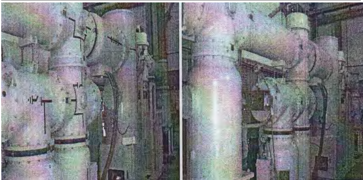
Рисунок 3 - Электрическое коммутирующее высоковольтное устройство 110 кВ
