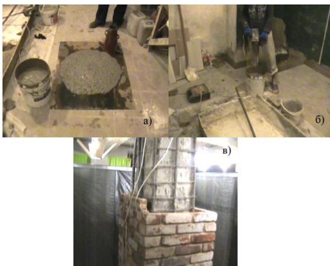
Рис. 2. Ремонт колонны с применением СУБ: а) – определение распłyва конуса для СУБ; б) – приготовление самоуплотняющейся бетонной смеси; в) – ремонтируемая колонна с несъемной опалубкой в виде стенки из кирпича
