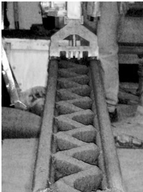
Рис. 2. Друк стіни – механізм із форсунками робить послідовні проходи з накладанням нових шарів бетону
