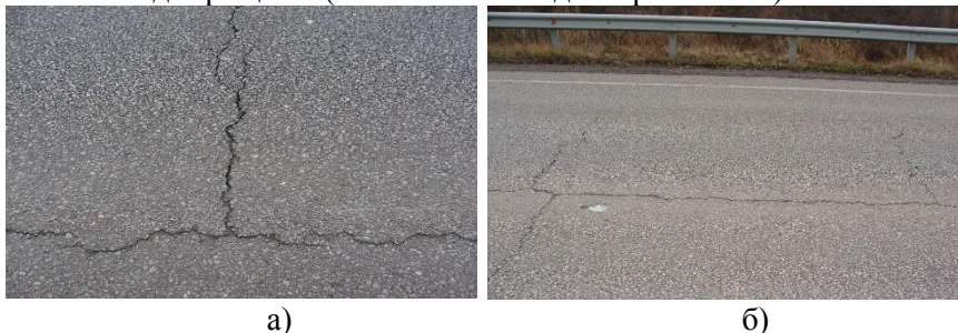
Рис. 1. Примеры Т-образных (а) и повторяющихся (б) трещин в покрытии дорог Харьковской области
