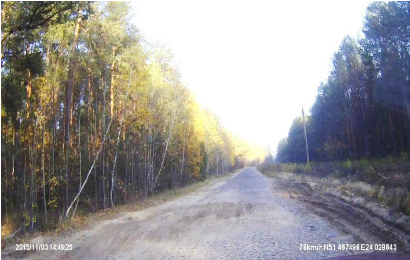
Рис. 2. Стан дорожнього покриття на ПК 79+25 а/д Т-03-06 /Т-03-02/ - Шацьк - Вілиця - Прип'ять - Любохيني - /Т-03-08/ (вибої, викришування та злушування).
