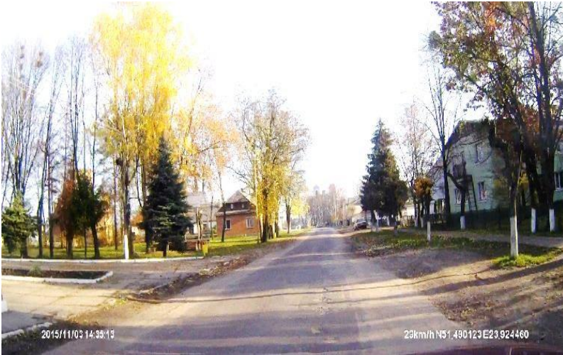
Рис. 1. Дефекти дорожнього покриття на ПК 2+30 а/д Т-03-06 /Т-03-02/ - Шацьк - Вілиця - Прип'ять - Любохيني - /Т-03-08/.
