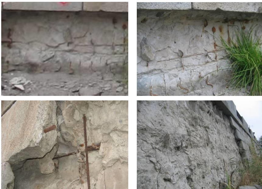
Рис. 2. Увеличенные фрагменты повреждений в местах разрушенной облицовки возле опоры ЛЭП у моста Чигирина
