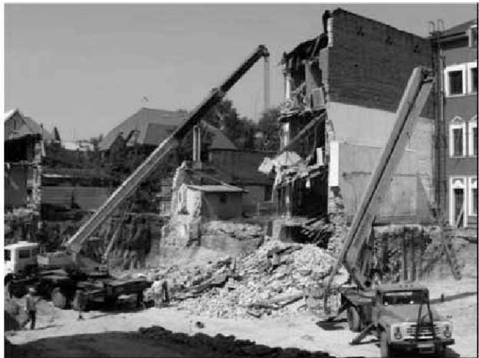
Рис. 1 Обвалення частини існуючого житлового будинку в м. Дніпропетровську
