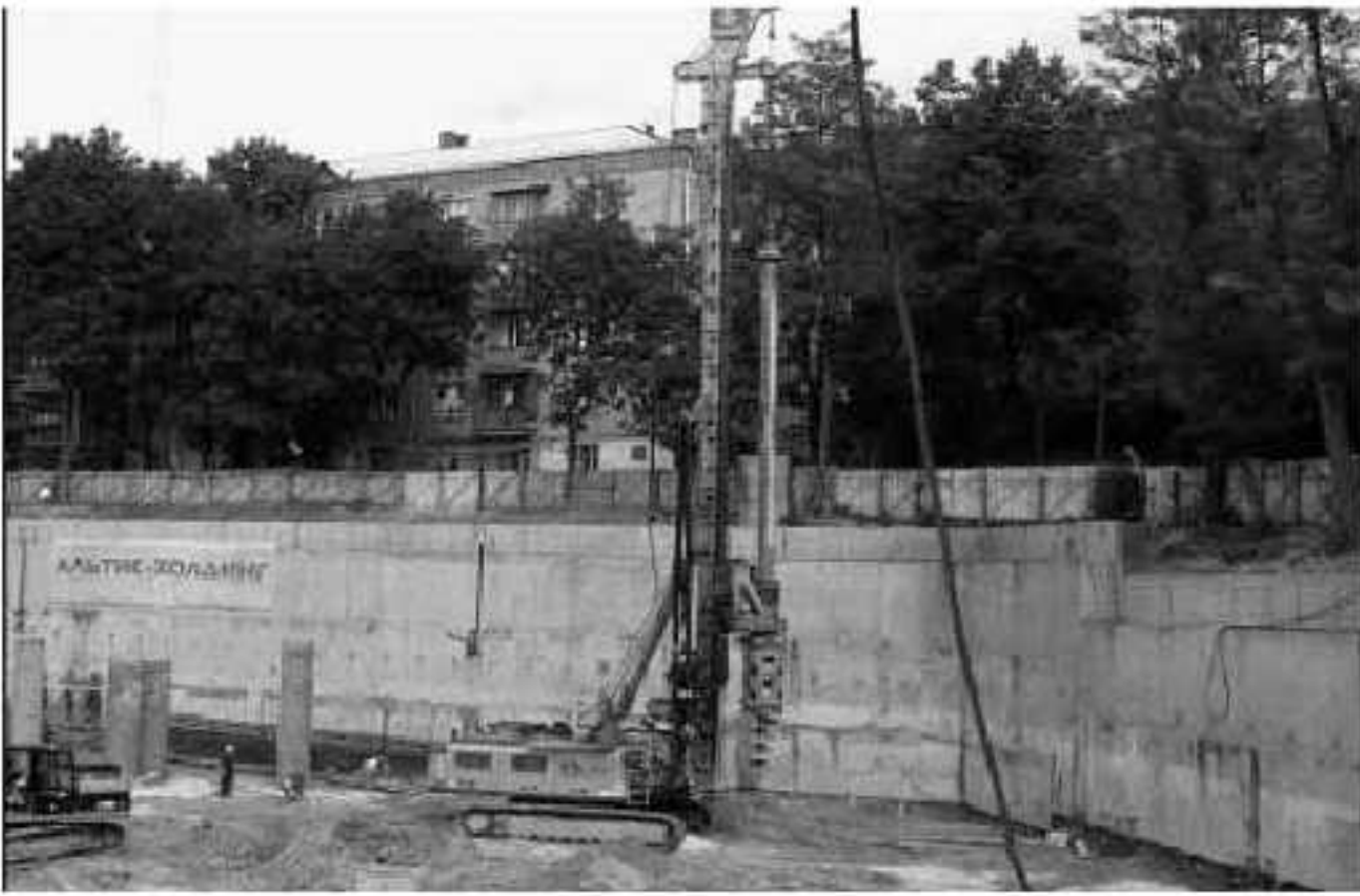
Рис. 3 Котлован під новий будинок на схилі в м. Києві, що призвів до деформацій існуючого житлового будинку
