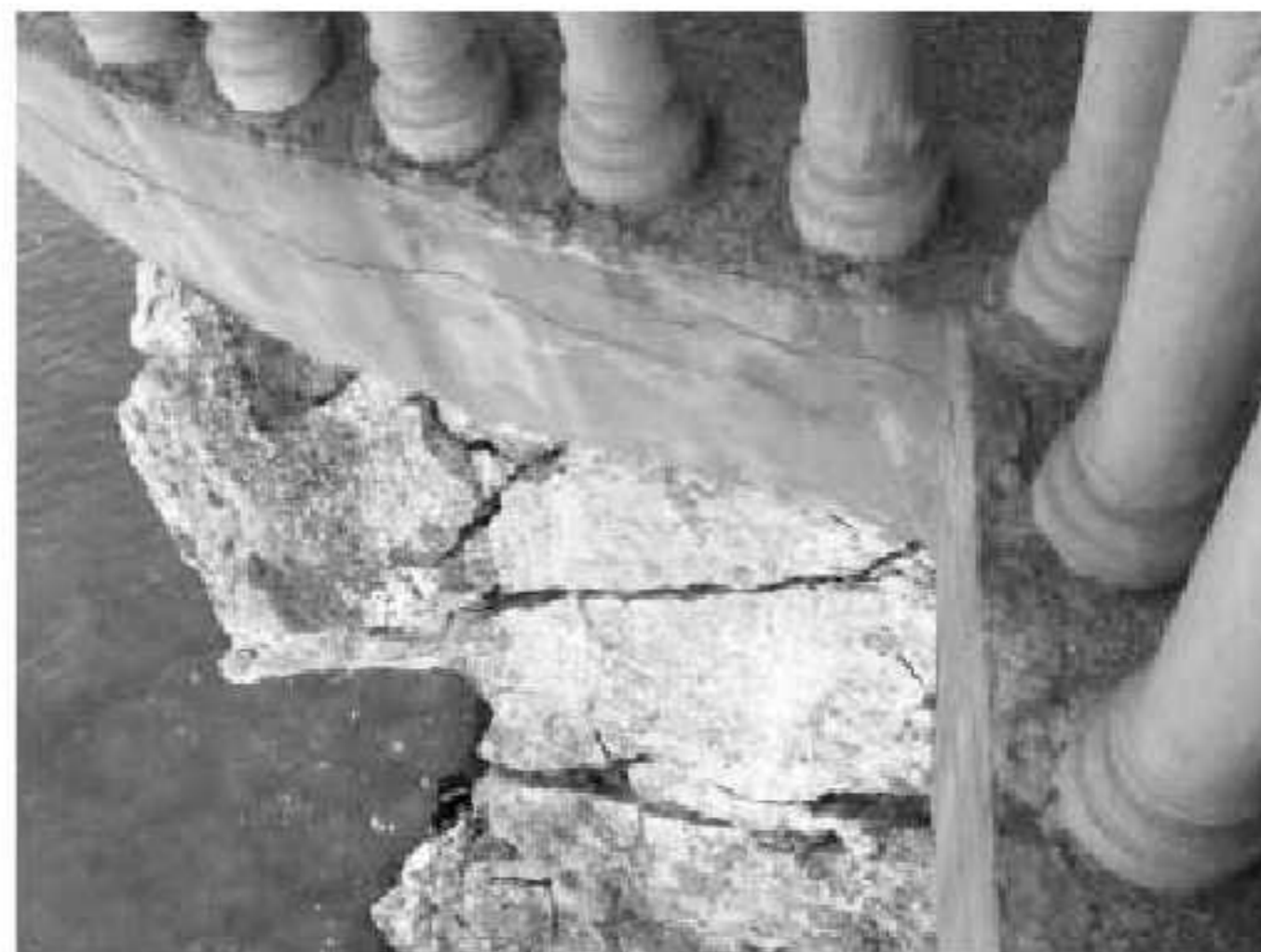
Рис. 8 Горизонтальная трещина по торцу плиты балкона
