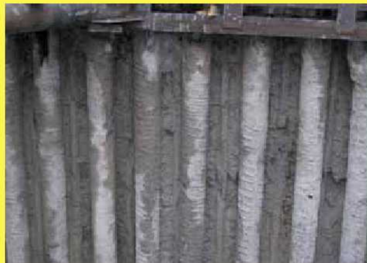
Рис. 9. Ограждение котлована из свай Ø300 мм и выполненными между ними панелями струйного инъецирования
