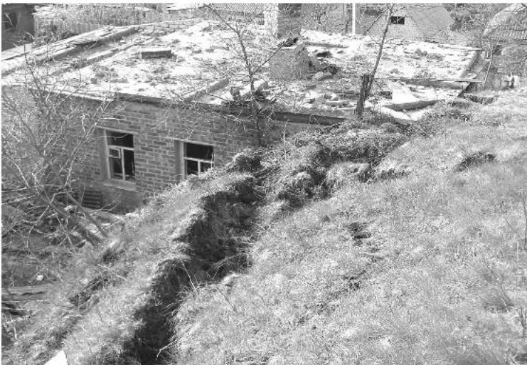
Активизация оползневых процессов (трещина отрыва) в г. Купянск Харьковской области
