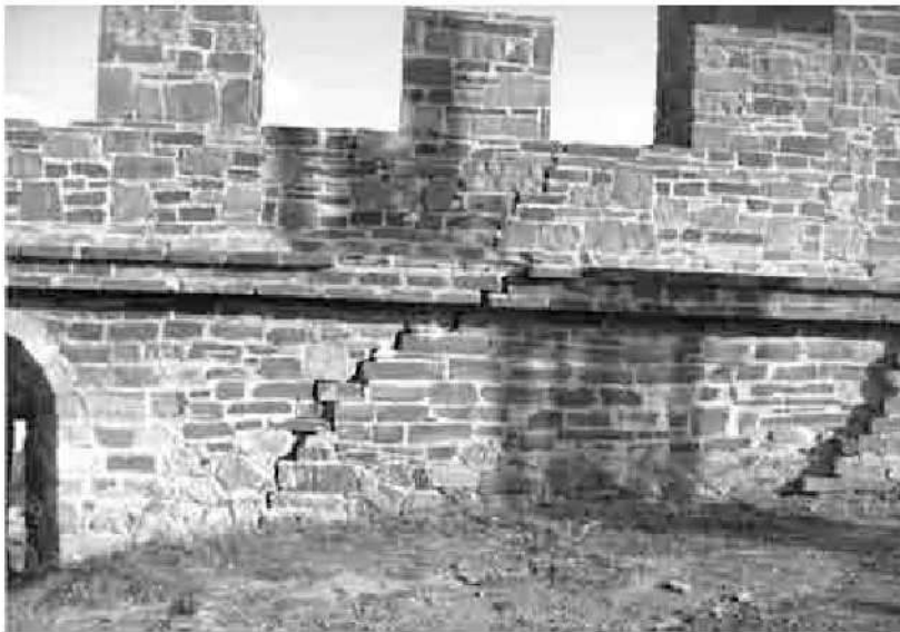
Рис. 4. Деформації стіни біля вежі Лукіно ді Фьєски ді Лаванья на внутрішній стіні нижнього ярусу фортеці, (2010 р.).
