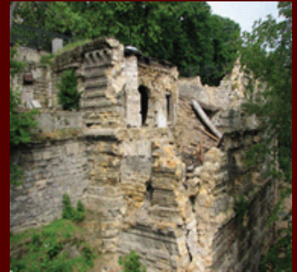
Рис. 6. Руйнування конструкцій Рибного ресторану в м. Одесі.
