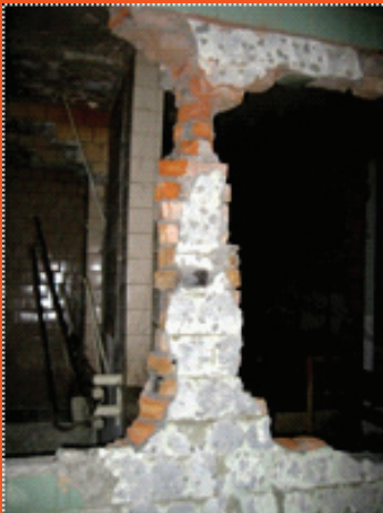
Рис. 1. Руйнування внутрішніх цегляних стін (Фірма «Краян»).
