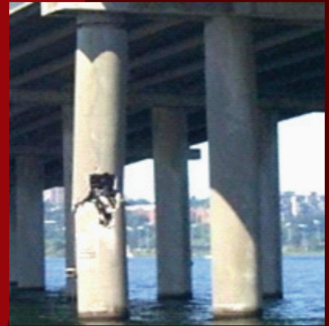
Рис. 3. Пошкодження опор мостового переходу (Хорватія).
