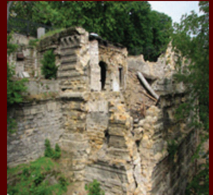
Рис. 6. Руйнування конструкцій Рибного ресторану в м. Одесі.
