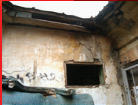
Рис. 5. Знос конструкцій одноповерхового будинку по вул. Утьосова в м. Одесі.
