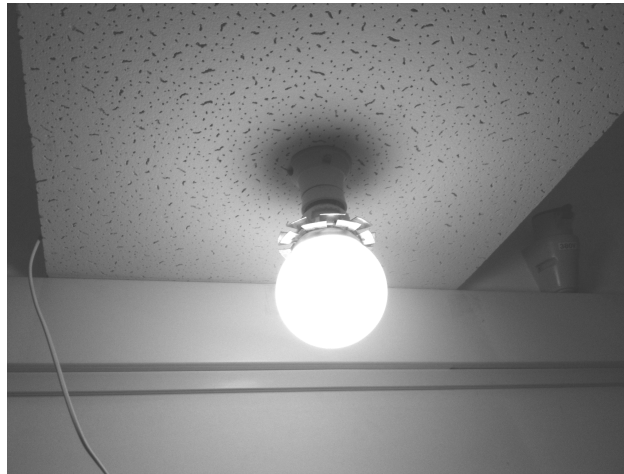
Рис. 4 – Загальний вигляд лампи-світильника
