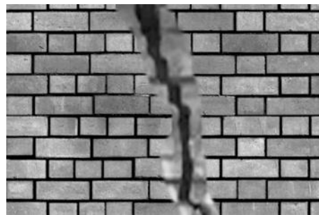
Рис. 1 Представлення тріщини на цегляній поверхні
