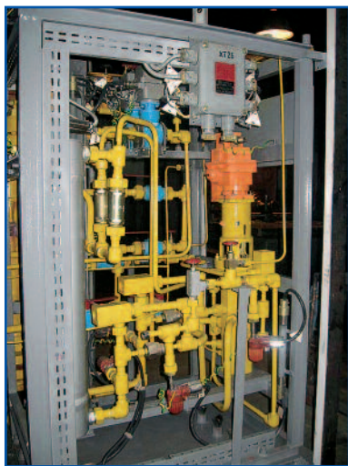
Фото 2. Блок адсорбционной осушки газа БОКЦ-25 с пневмораспределителем
