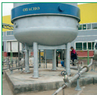
Фото 2. Криогенный трубопровод с экранно-вакуумной изоляцией в составе системы хранения
