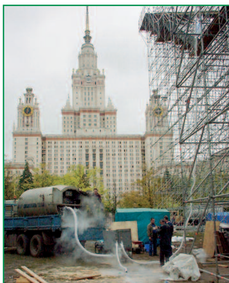
Фото 1. Слив жидкого азота из транспортной ёмкости (ЦТК-5/0,25) в генератор снега через гибкий металлорукав
