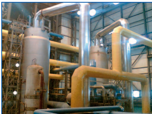
Фото 7. Блок комплексной очистки воздуха с двумя адсорберами R01 и R02
