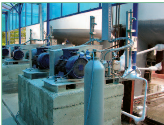
Фото 3. Насосы высокого давления
