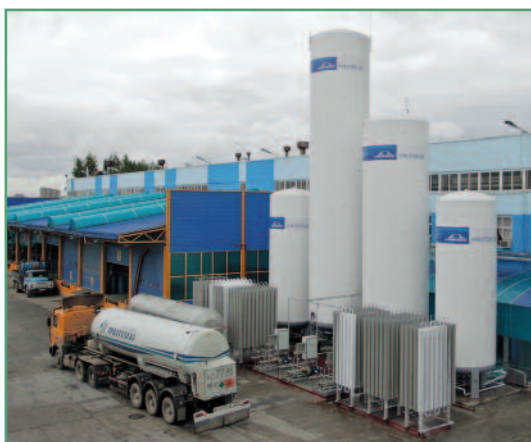
Фото 4. Общий вид наполнительного отделения с размещёнными снаружи ёмкостями, испарителями и насосами
