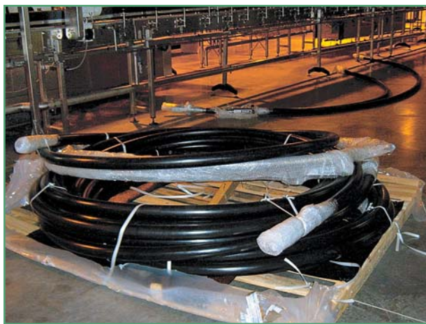
Фото 4. Гибкий криогенный трубопровод «Криофлекс-39/66» на монтажной площадке
