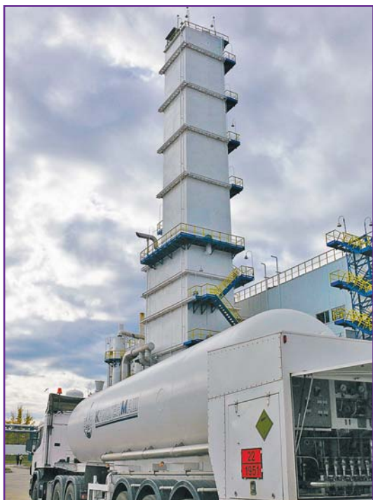
Фото 10. Блок разделения воздуха нового кислородно-азотного цеха Северского трубного завода. Его основу составляет современная крупнотоннажная ВРУ КДАДАр-9/3 и ожижительная установка ОКА-3000, которая производит 2000 кг/ч жидкого кислорода и 1200 кг/ч жидкого азота. Инвестиции ОАО «Криогенмаш» в реализацию этого on-site-проекта составили примерно 24 млн. евро
