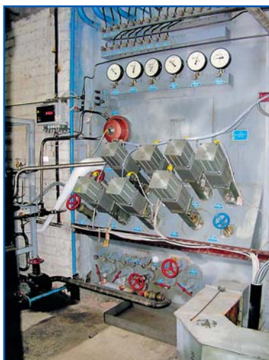
Фото 2. Передняя панель блока разделения с арматурой и пневмоцилиндрами
