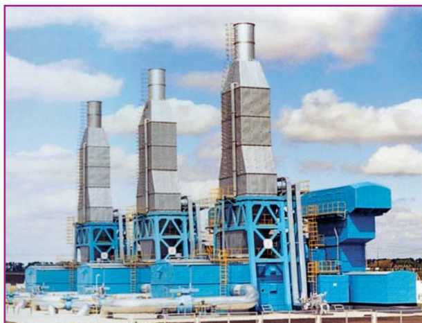
Фото 1. Компрессорная станция «Тарутино», укомплектованная агрегатами ГПА-Ц-16С
