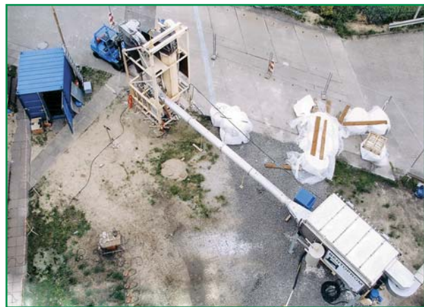
Фото 2. Вид сверху на мобильный комплекс
