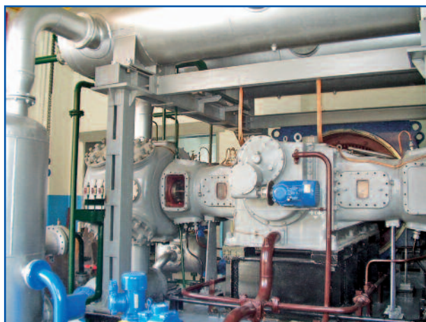
Фото 3. Вид компрессорной установки 4BM10-55/71М1 блочного исполнения на Полтавском заводе медицинского стекла
