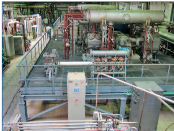
Фото 2. Компрессор 4BM10-55/71 с площадкой обслуживания
