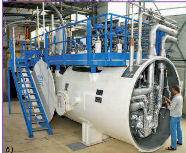
Фото 14. Криомодуль КГУ 18000/4,5 (18 кВт на 4,5 К) фирмы «Air Liquide»: а, б — вертикальный и горизонтальный блоки
