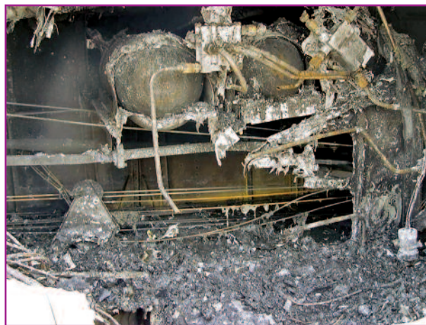
Фото 2. Последствие загорания кислородного распределительного блока
