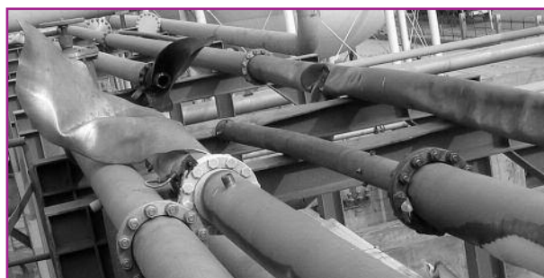
Фото 5. Повреждения после загорания трубопровода жидкого кислорода с вакуумной изоляцией
