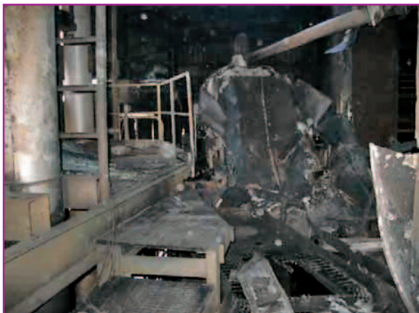
Фото 10. Разрушения в помещении после взрывного воспламенения клапана
