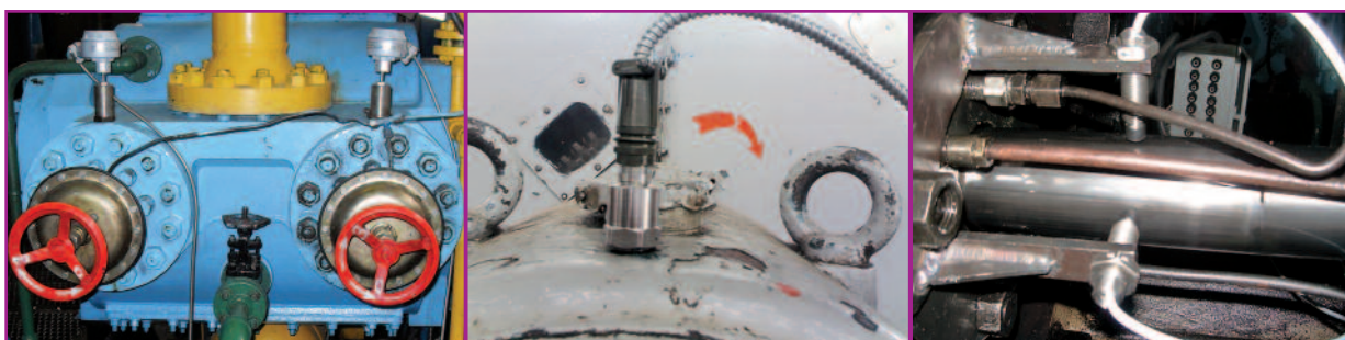
Фото 2. Примеры установки датчиков на компрессорном агрегате
