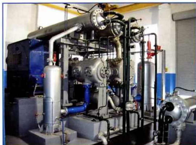
Фото 1. Общий вид компрессорной установки 4ВМ10-55/71 (4ВМ10-65/71) на Полтавском заводе медицинского стекла
