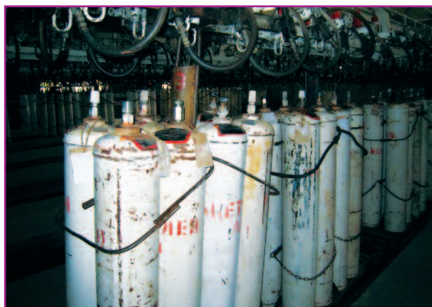
Фото 1. Сварные ацетиленовые баллоны на наполнительной рампе у одного из российских предприятий
