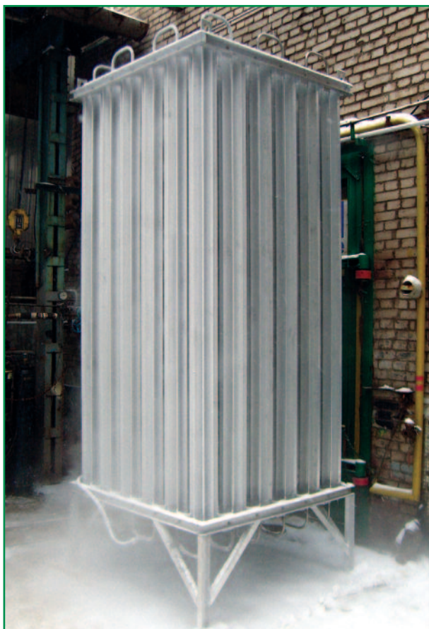
Фото 4. Испаритель ИВ-0350-С во время проведения натурных испытаний
