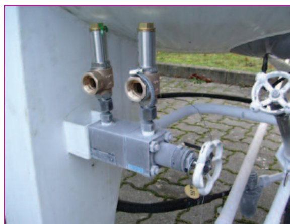
Фото. 2. Место установки предохранительного клапана на резервуаре хранения жидкого азота
