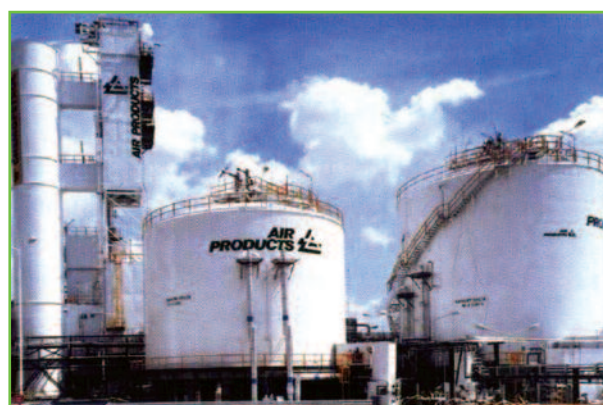
Фото 3. Вид эксплуатирующихся резервуаров
