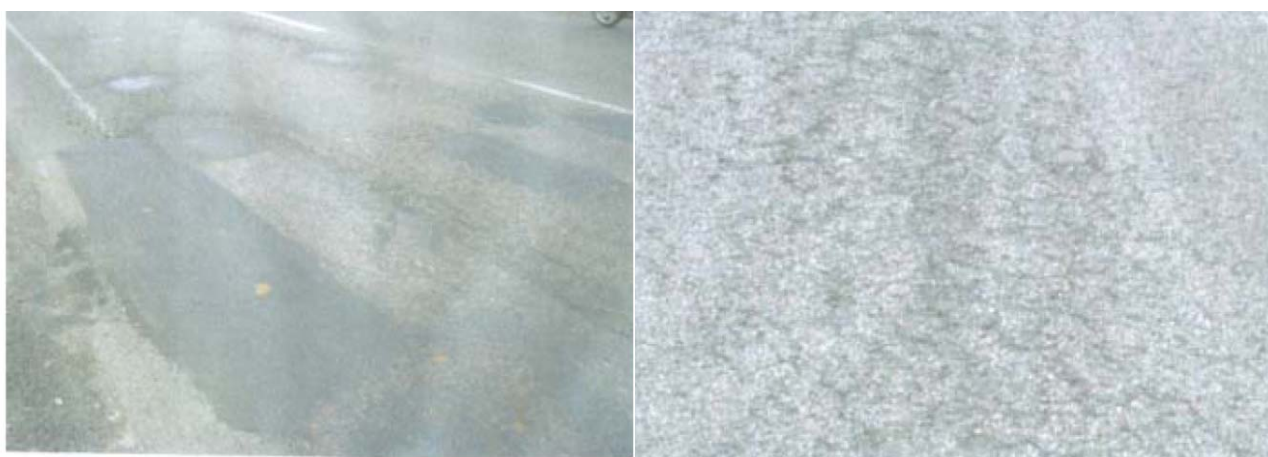
Рис. 2. Дефекти на ділянці автомобільної дороги Київ-Ковель (км 297+700 – км 302+400) через 8,5 років після виконання холодного ресайклінгу
