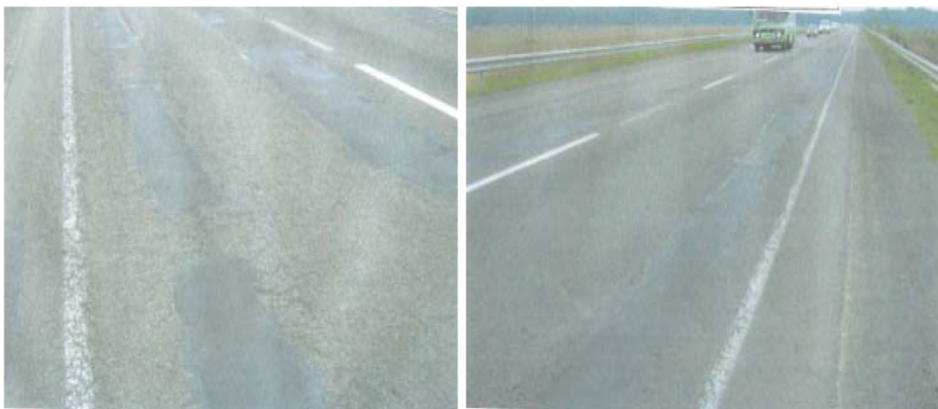
Рис. 13. Фотоматеріали дефектів на ділянці автомобільної дороги Київ-Ковель (км 297+700 – 302+400) через 8,5 років після виконання холодного ресайклінгу
